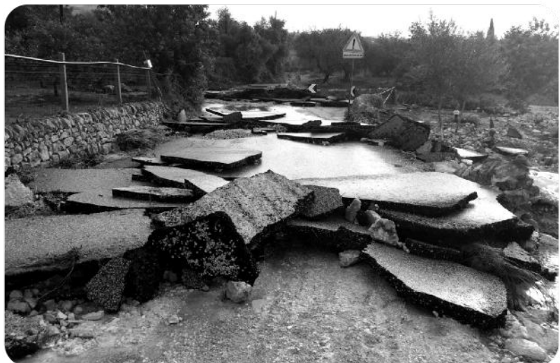
Esempi di danni alle infrastrutture in Calabria e Sicilia
